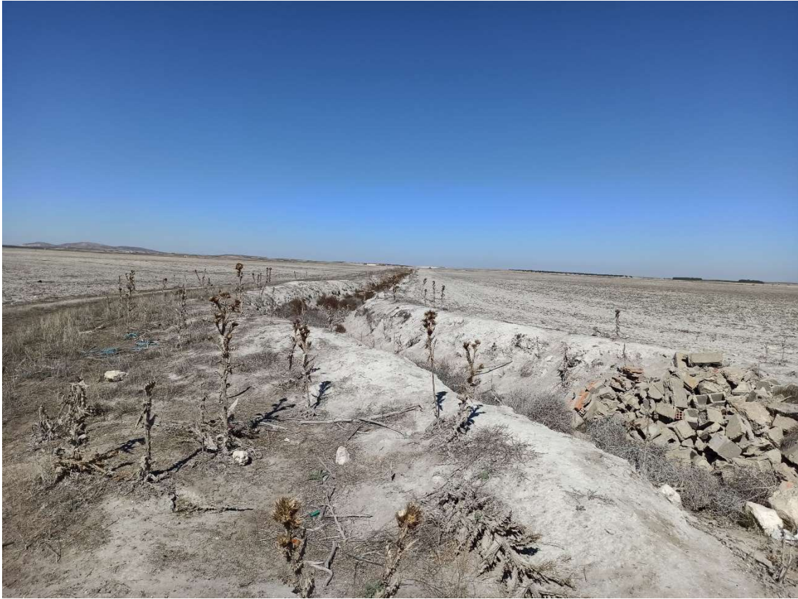
Figura 61: Tramo de canal a la altura de la Casa del Vado del Palo, aguas abajo de Villacentenos y término de Alcázar de San Juan. Con independencia del vertido de escombros, se aprecia que el ancho de la solera del cauce es mucho menor que los tramos entre el molino del Cuervo y el del Tejado.
