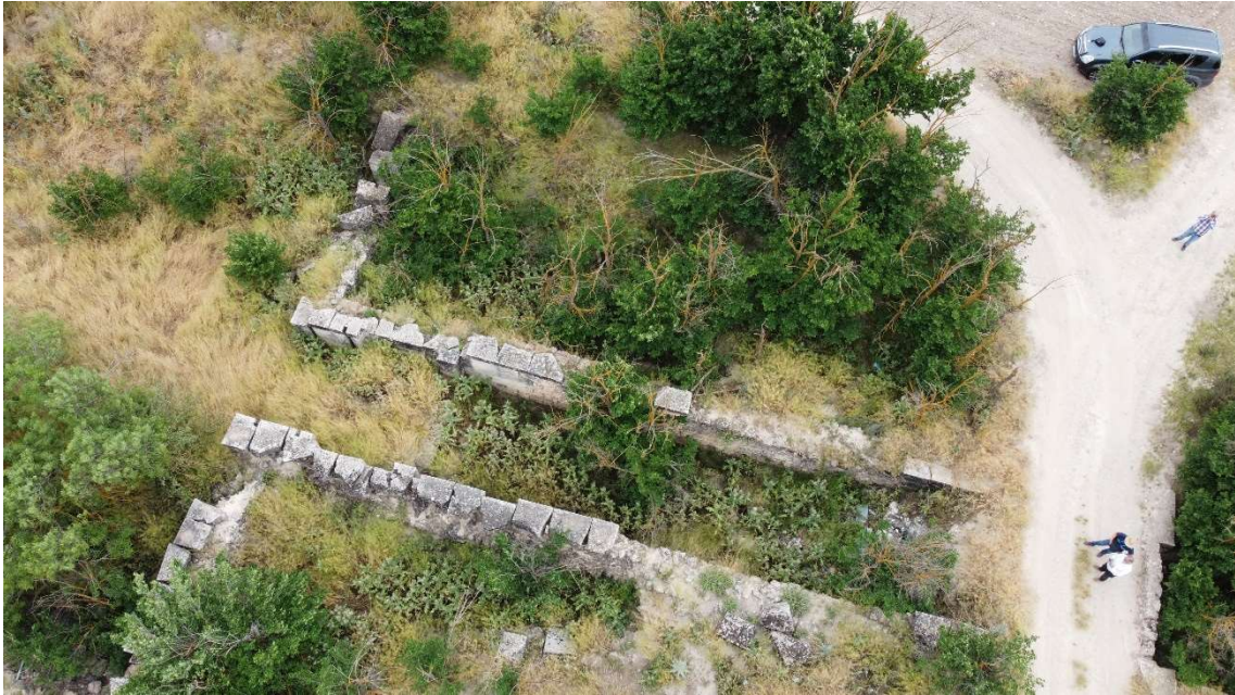
Figura 58: Vista aérea de puente y esclusa de Villacentenos, despoblado de Alcázar de San Juan. Parece que su nombre de “Baños” se debe a que su último empleo era servir de baños para la parada de caballos del último Gran Prior, el infante don Sebastián. Obviamente su funcionalidad prevista no era esta.
