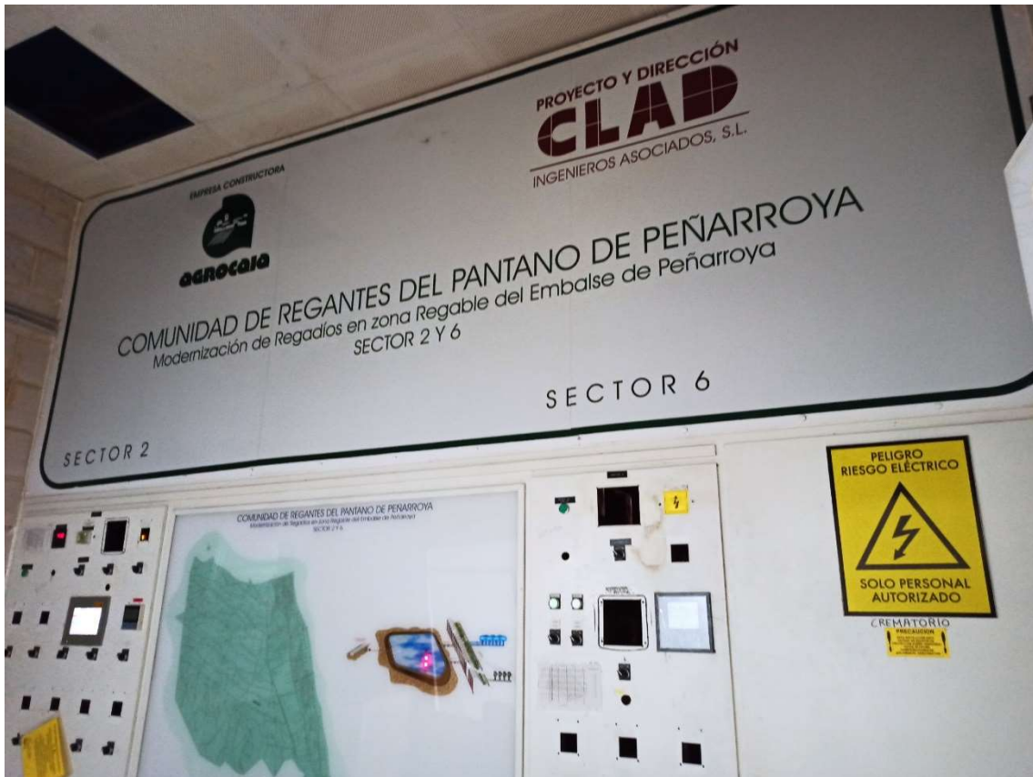
Figura 17: Estación de control en el área del Molino de Santa María para el riego en la actualidad mediante tubería subterránea e hidrantes.
