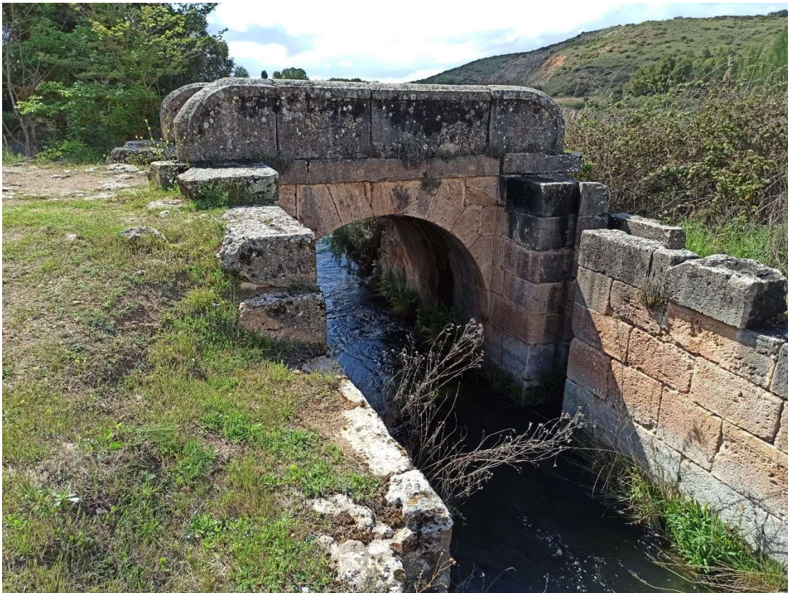
Figura 09: Puente y esclusa de la Magdalena. Diseñado por Juan de Villanueva. Término de Ruidera.
