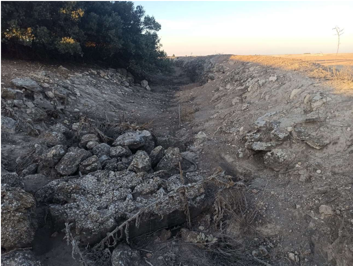
Figura 50: Tramo entre casa Minguillo y Alameda de Cervera. Vestigios del canal con refuerzo de mampostería.
